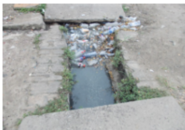
Blocage d'un petit canal (Kinshasa, février 2019)
